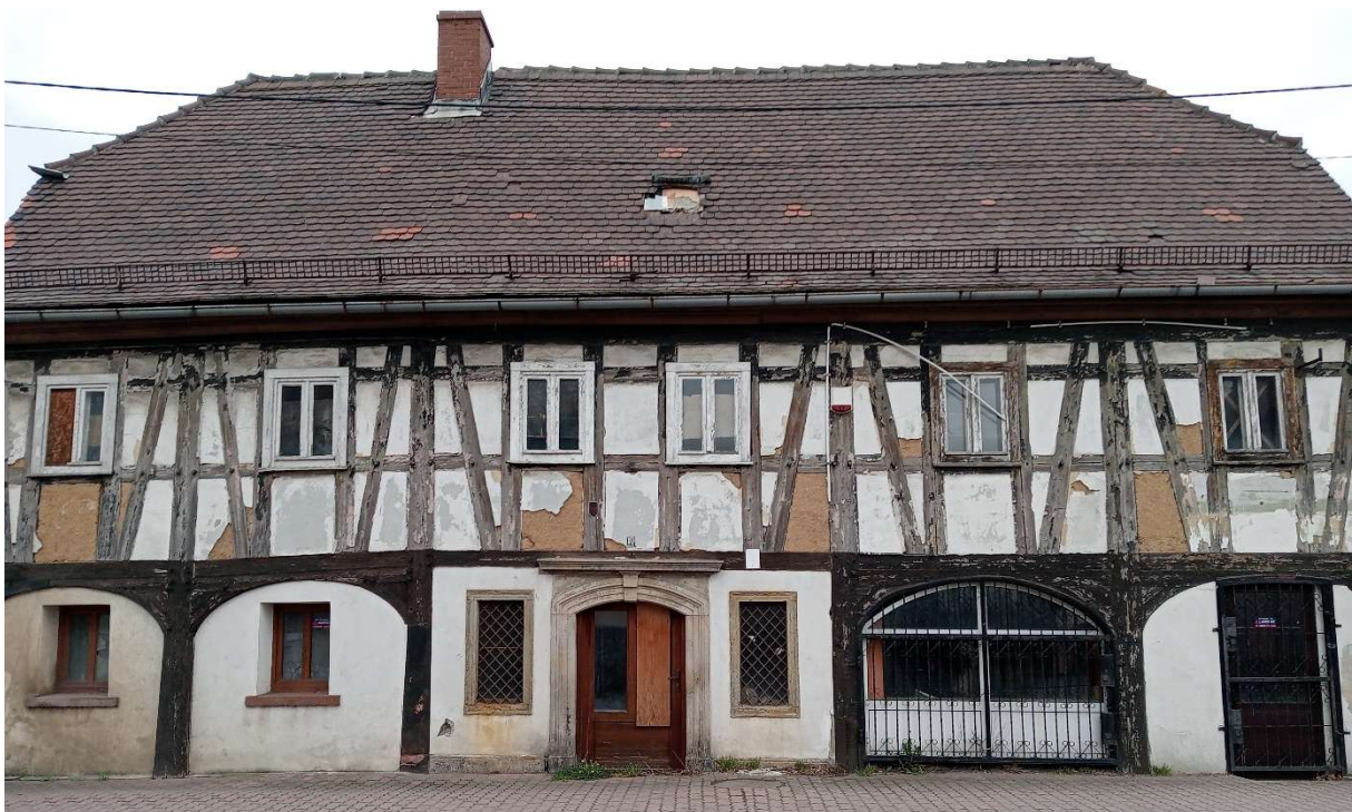
Rycina 19 Przykłady zabudowy mieszkaniowej w złym stanie technicznym
