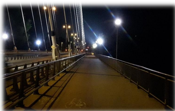
Foto. nr 11. Oświetlenie drogi dla rowerów i drogi dla pieszych na moście.
